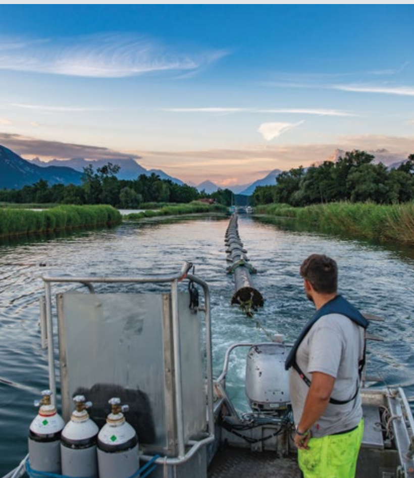
▲ Construction de la conduite d'eau pour le siège du Comité international olympique de Vidy (Suisse).
