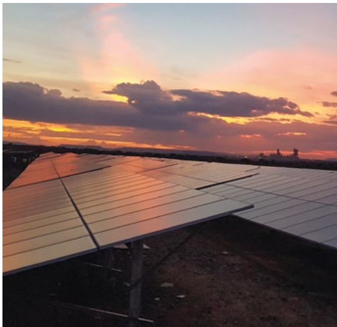
◀ Centrale solaire de Bharathi Cement (Inde).
